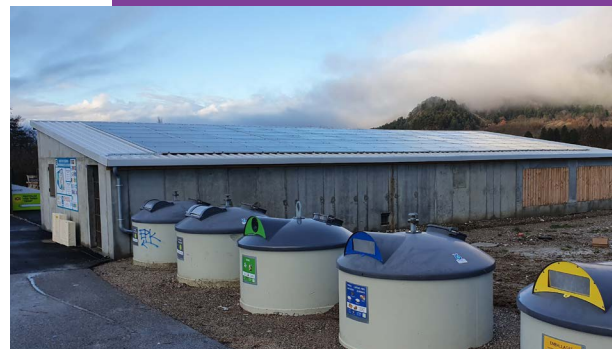
Photovoltaïques en toiture de l'aire de tri de Luc-en-Diois
